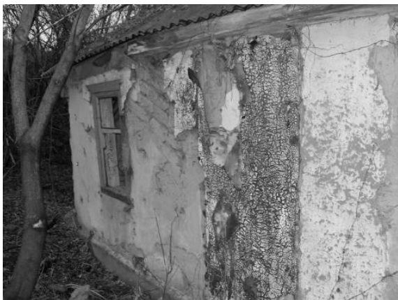
Рис. Б.2. Уліплена стіна хати глиною з соломною (м. Чугуїв, вул. Харківська, будівля початку XIX ст.)
